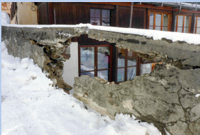
Loch in der Höflimauer
